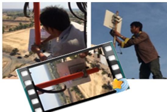
รูปที่ 7 การติดตั้งด้านสถานีฐาน
