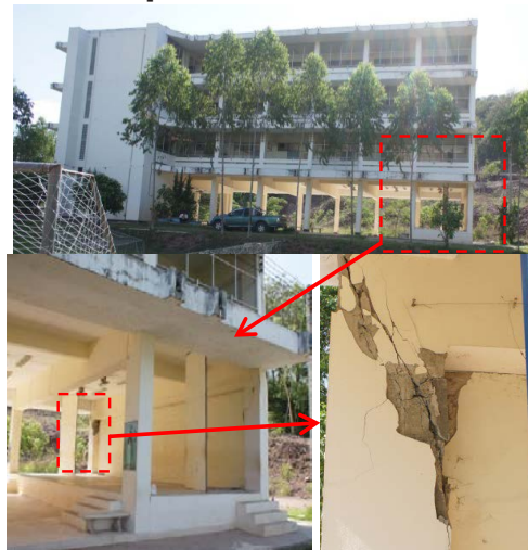
รูปที่ 4 ลักษณะความเสียหายของอาคารที่มีผนังอิฐก่อ
