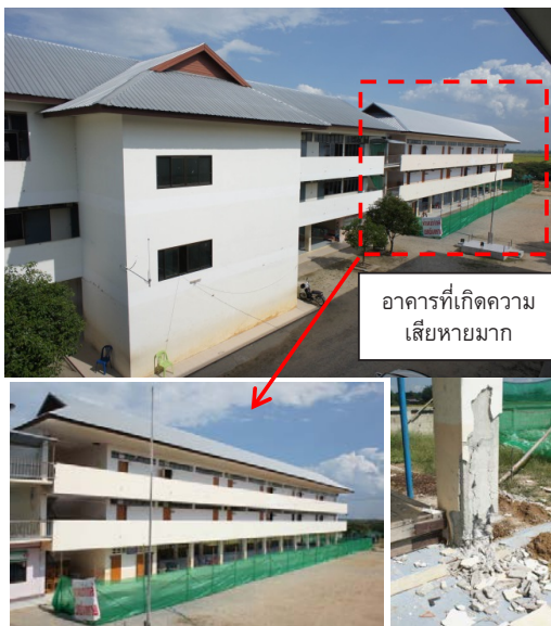
รูปที่ 3 อาคารเรียนที่เกิดความเสียหาย
