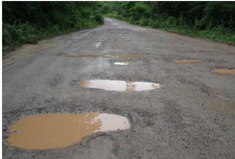
รูปที่ 1 ความเสียหายของถนนที่ต้องทำการซ่อมแซม
